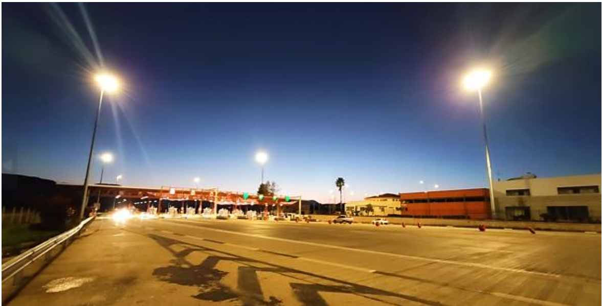
Εικόνα 5: Φωτιστικά σώματα νέας τεχνολογίας, τύπου LED, στον σταθμό διοδίων Σπαθοβουνίου.
